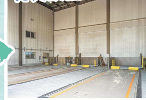
トラック・ダンプで運ばれてきた小麦を受入する設備
