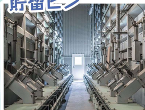
受入後または乾燥後に一時的に保管する通風装置付き設備
